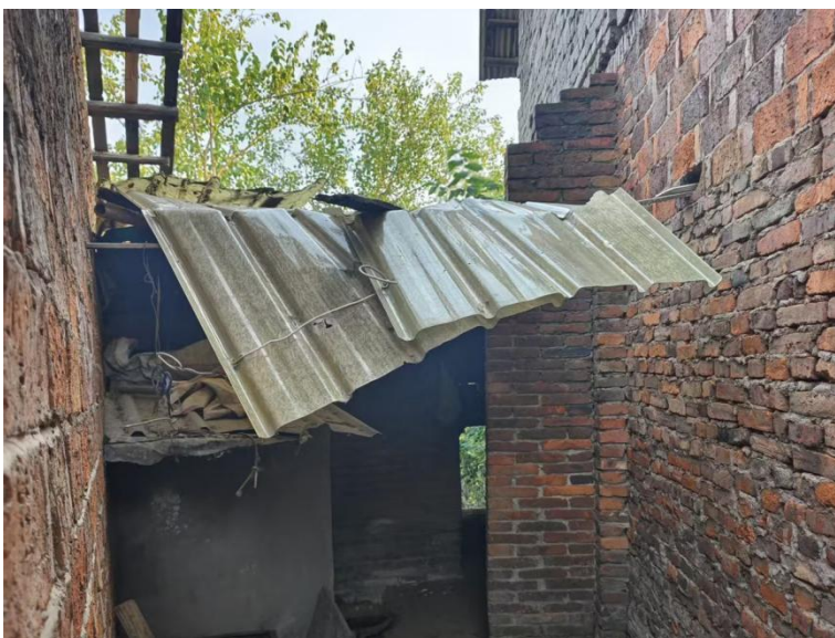
事故发生后涉事杂物棚现场情况
