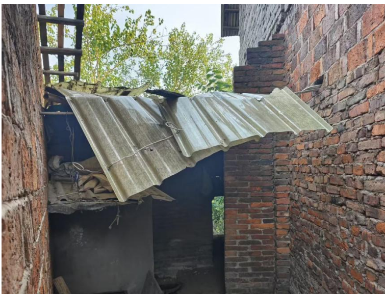
事故发生后涉事杂物棚现场情况
